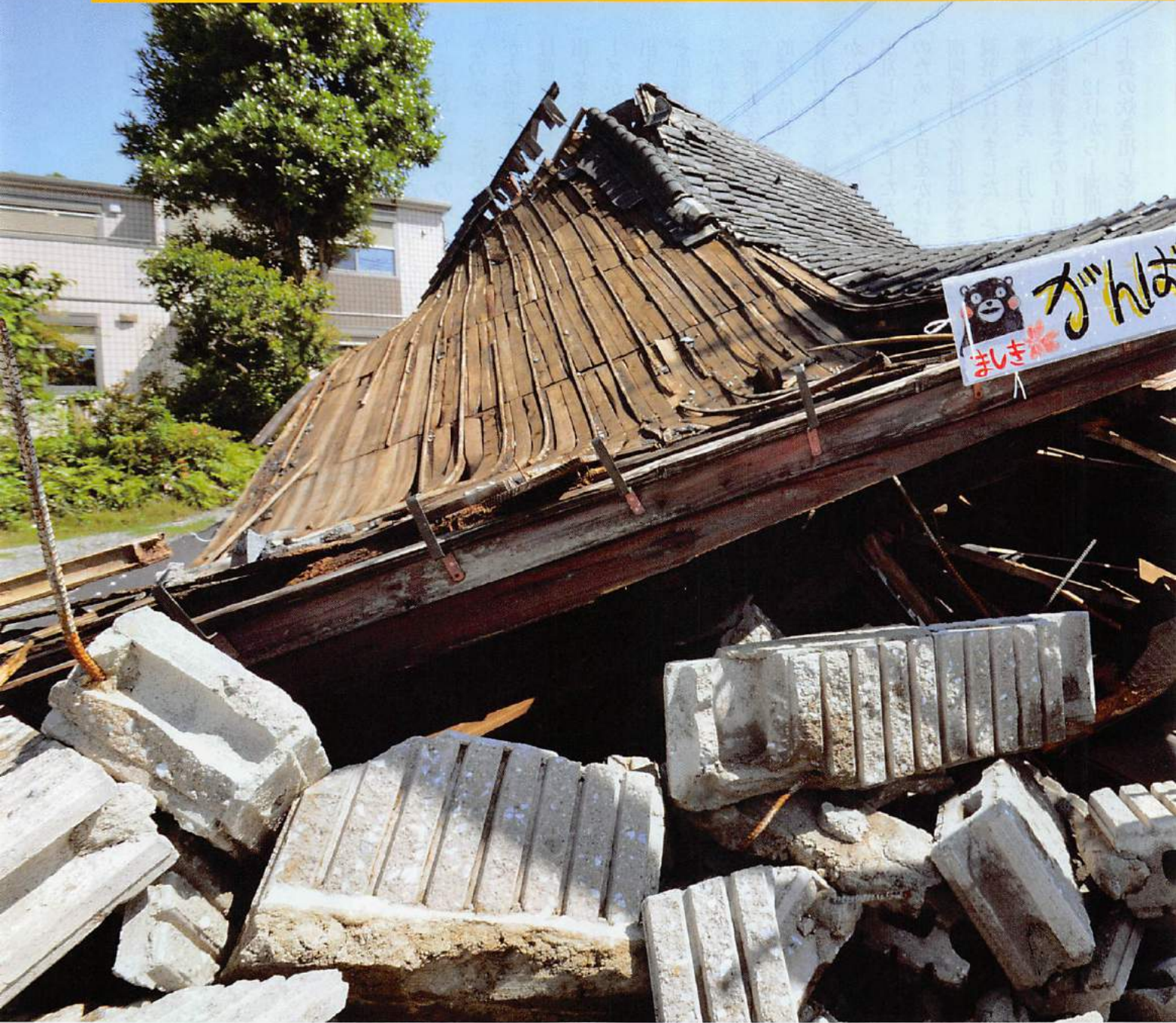
2度も震度7の激震に見舞われた益城町では町のあちこちで建物の倒壊が見られる。写真は特に被害が甚大だった安永地区
